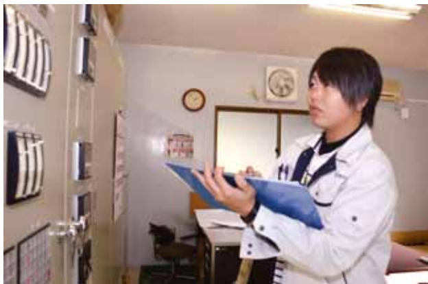
親之谷浄水場機械室で運転状況を確認する様子
